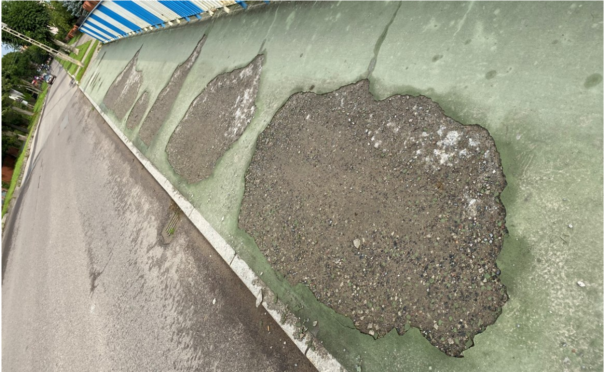
Zdjęcie przedstawia uszkodzoną nawierzchnię chodnika na moście przy ulicy Kazimierzowskiej.
